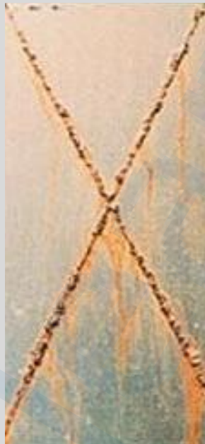
Corrosión después de 1450 horas
